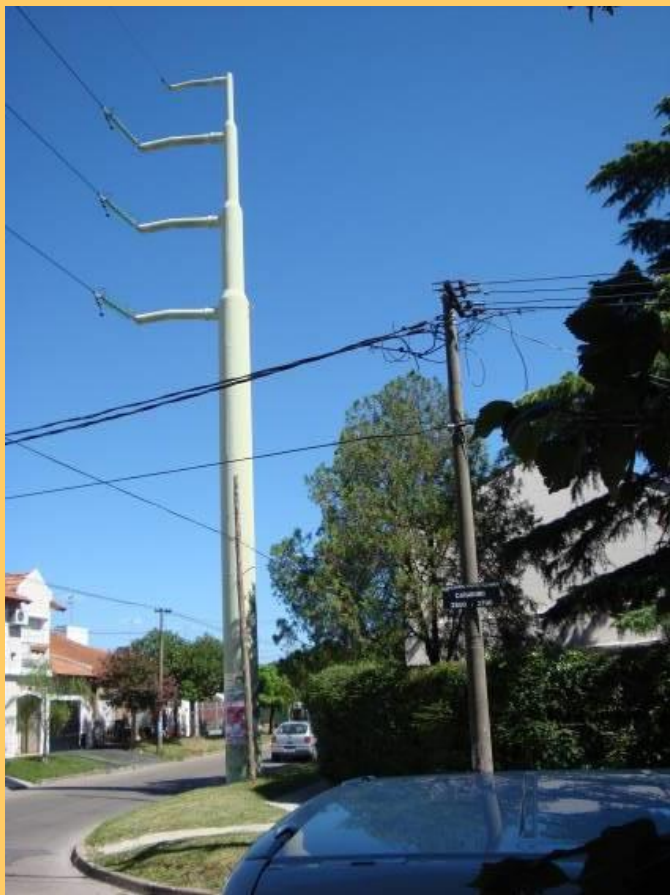
Tendido de alta tensión en las calles Carabobo y Costa Rica en el Barrio Villa Las Naciones. Archivo propio. Diciembre 2010
